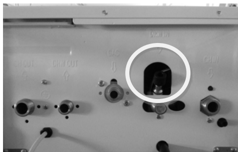
Рисунок 6 – Кран подпитки водой CO
